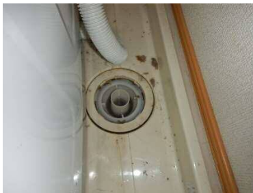
①洗濯機置き場の排水不 良の連絡！緊急出動！
