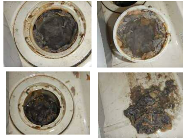
②原因は洗濯カスやゴミが溜ま り排水出来ない為と確認。 排水トラップを外し、清掃。
